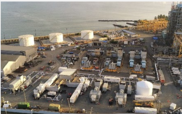
Palo Seco Fast Power 175 MW
